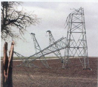
Doc 3 Une ligne T.H.T. endommagée lors de la tempête de 1999.
